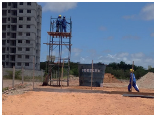
Figura 4 – Utilização de cinto de segurança em trabalho em altura, funcionários utilizando capacete
