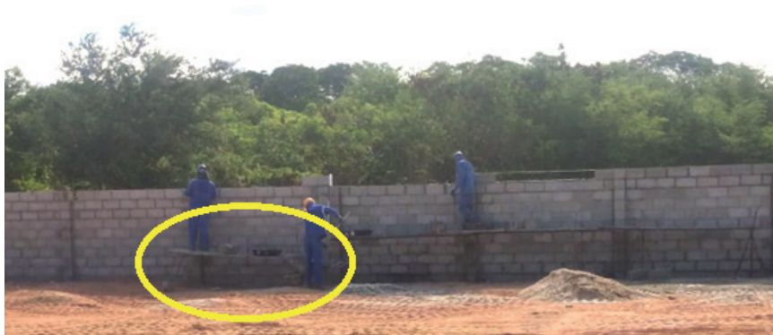
Figura 8 – Andaime sem travamento e o piso desalinhado
