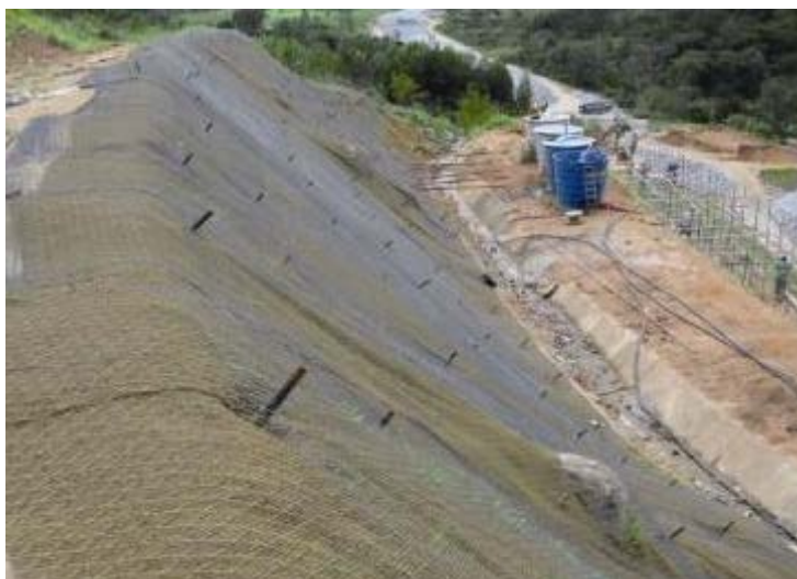
Figura 9 – Detalhe das telas metálicas no emboque norte do Morro Agudo, em Paulo Lopes
