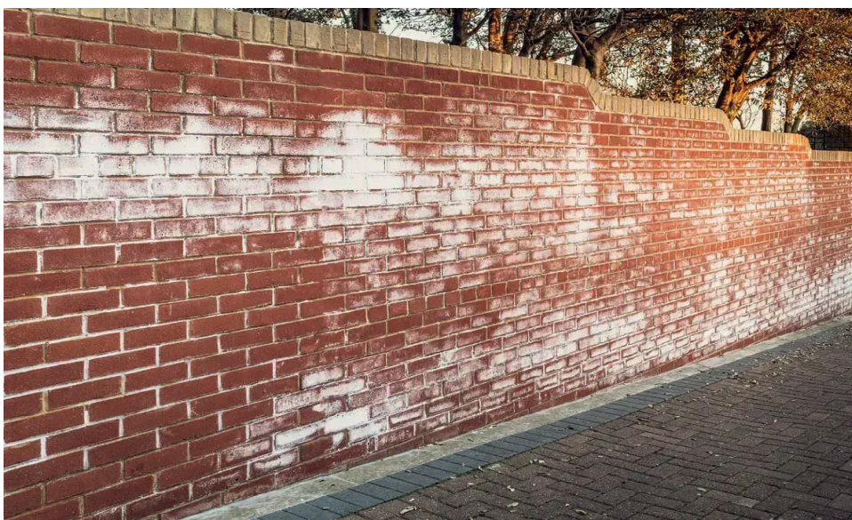
Figura 2 – Eflorescência em muro de tijolinho
