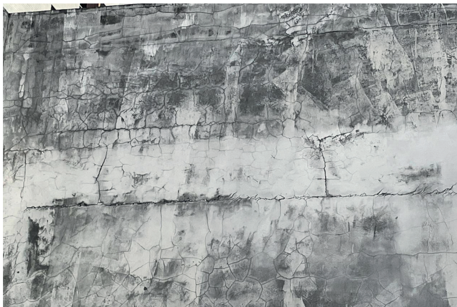
Figura 11 – Fissuras de retração
